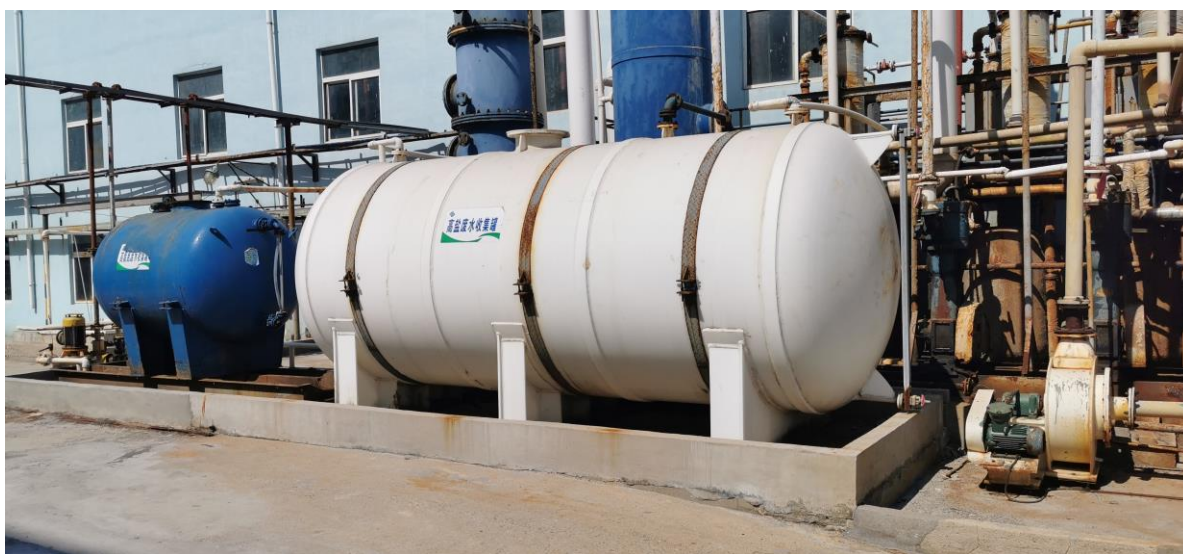
图 4.1-2 五车间南侧高盐废水收集管及生产装置
